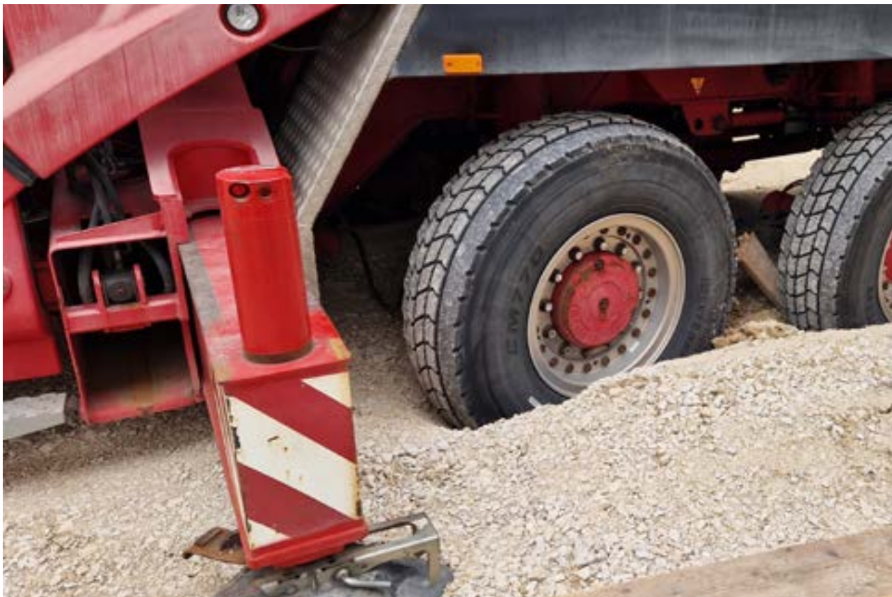
Illustration 1 af Bent Jensen: Kran kørt fast i dårligt vibreret underlag.
